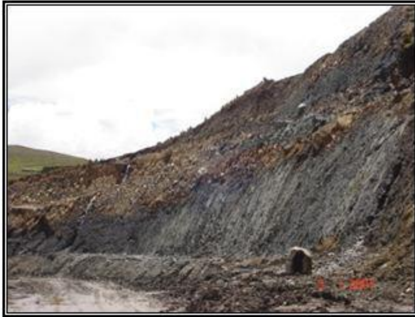
Foto 3: La presencia de agua es constante en el lugar requiere soluciones de Drenaje.
