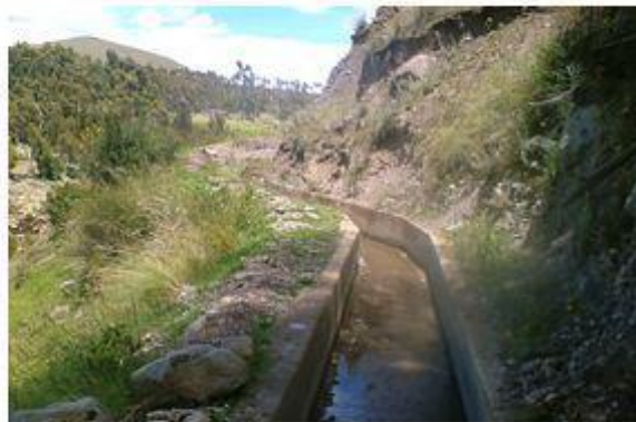
Foto 2. Km 77+760. Vista del canal Yanama, revestido en concreto armado, con sección rectangular de 0.60 m de ancho por 0.45 m de alto.
