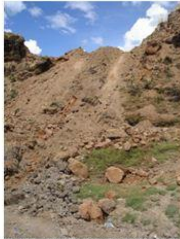
Foto 02: Km 35+860 – Manantial tapado por la tierra. Hacer la captación.
