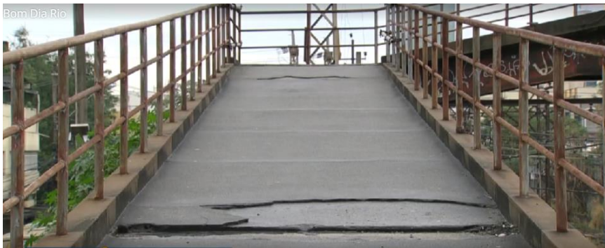
Figura 28: Passarela danificada no centro de Nova Iguaçu
