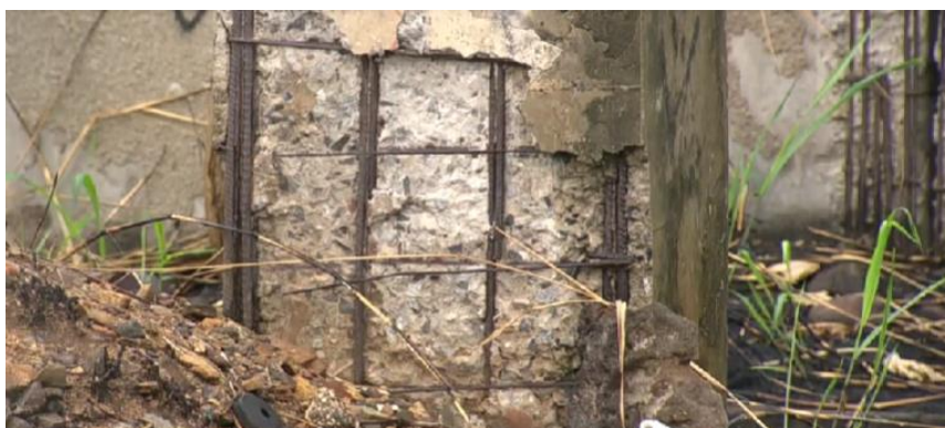
Figura 29: Ferragens expostas no centro de Nova Iguaçu
