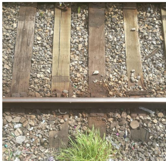
Figura 31: Dormentes rachados na Estação de Santa Cruz
