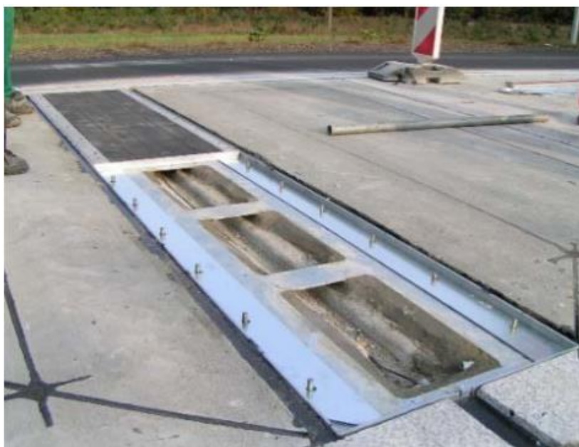
Figura 2.13: Instalação de sensores “ Bending Plate ” Fonte: Sroka et al. (2019)
